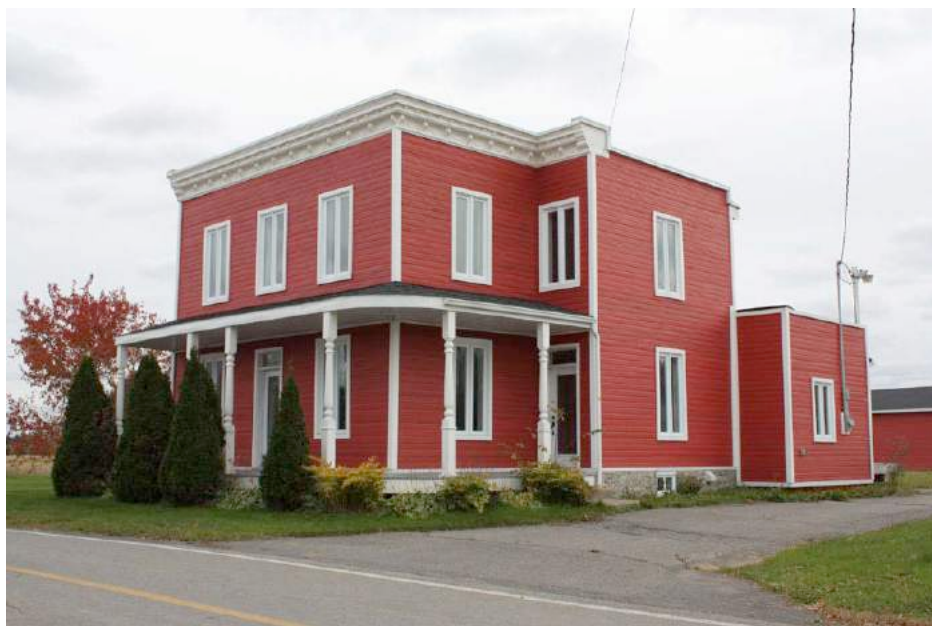
En 2011, les murs du 222, 1 re Avenue ont été recouverts de planche à feuillure. Quoique le résultat soit fort acceptable, il aurait été préférable de conserver et de restaurer les murs de brique. IMG_9126.jpg
